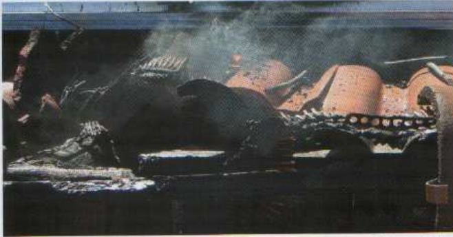
Der Brandherd saß direkt unter den Modulteilen der Photovoltaikanlage. Ein Kurzschluss nach dem Biss eines Marders hatte den Brand ausgelöst.
