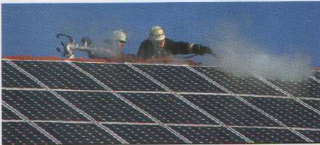
Die direkte Brandbekämpfung (hier mit einem Kohlendioxid-Feuerlöscher) im Bereich der Photovoltaikanlage zeigte keine Wirkung. Erst nach dem Durchtrennen der Kabel, die zu den Modulen führten, wurde die Spannungsversorgung unterbrochen und der Lichtbogen erlosch.
